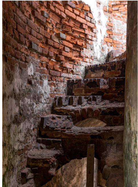
Gambar 38 Tangga pertama yang kondisinya sudah rusak berat
