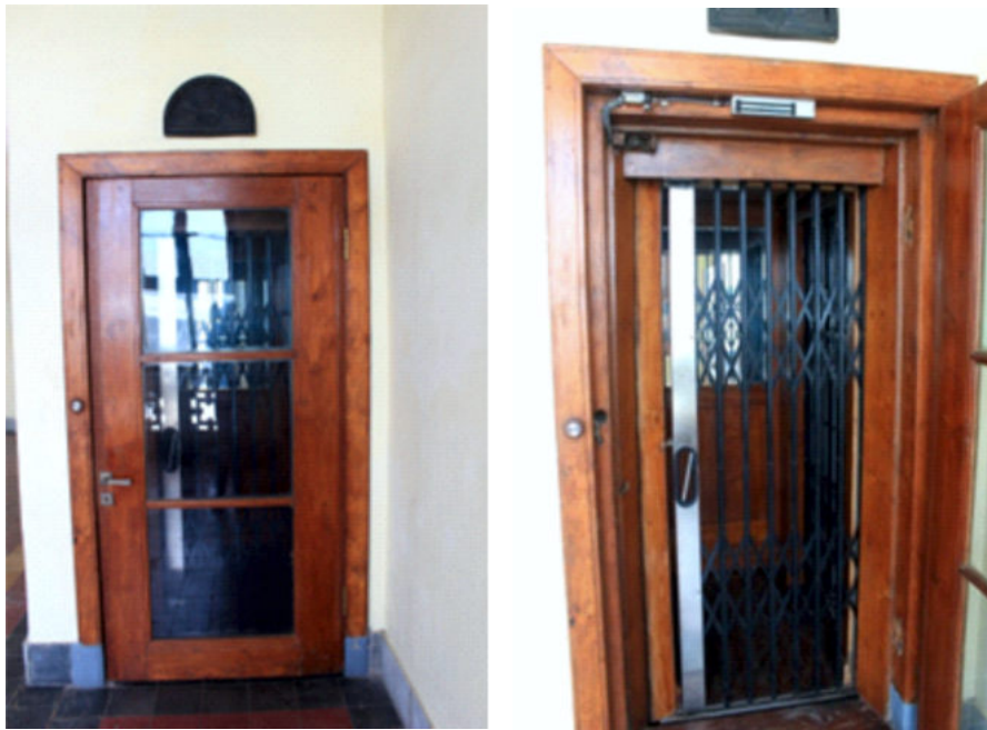
Foto 10. Lift Gedung Jasindo
