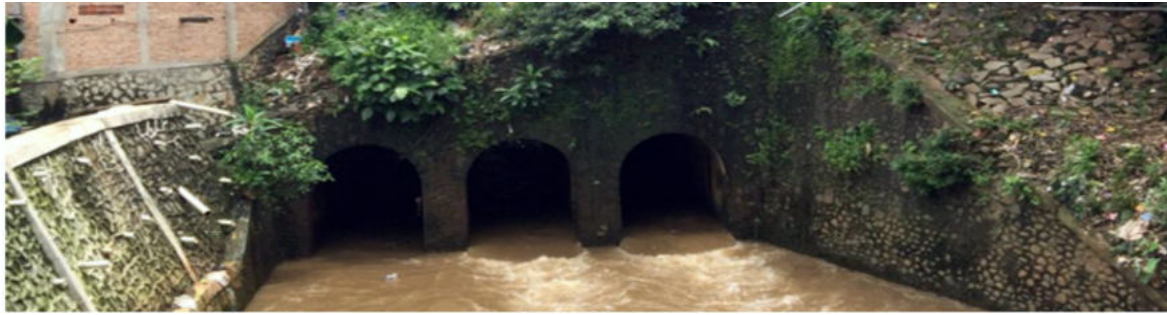
Foto 23. Kondisi Eksisting Jembatan Kereta Terowongan Tiga (Survei TACB 2020)
