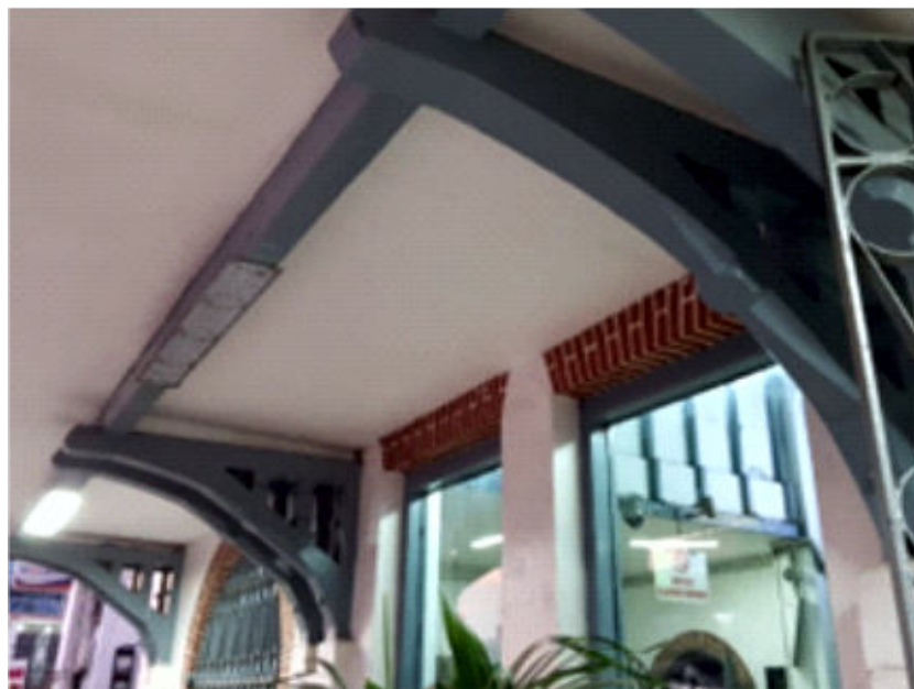
Foto 25. Struktur kayu lengkung penyangga kanopi pintu masuk utama Stasiun Jatinegara (Survei TACB 2019)
