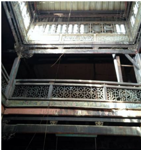
Foto 5. Void Pada Lantai Dua Bangunan Sumber: Dokumentasi PKCB, 2018
