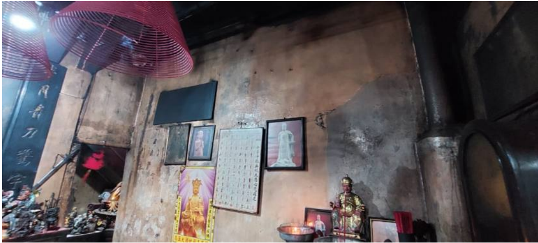
Foto 6. Kerusakan Bangunan Sin Tek Bio Sumber: Survei PKCB, 2021
