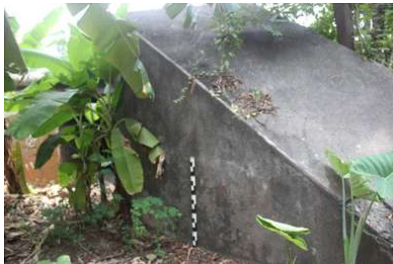
Foto 9. Dinding miring pada bangunan G2 (Survei TACB 2017)
