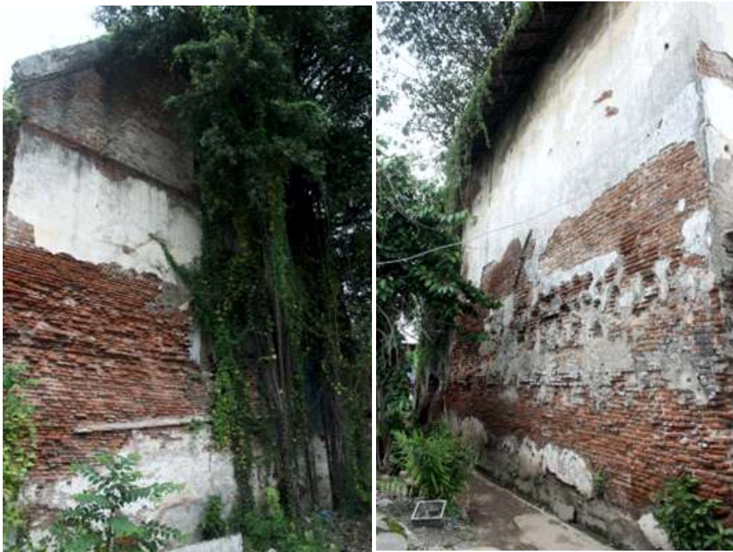
Foto 9. Kerusakan pada dinding samping bangunan
