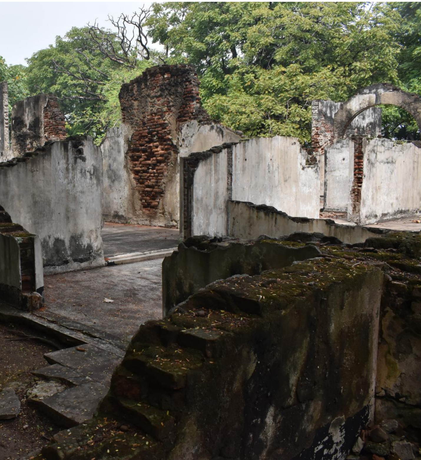
Sisa reruntuhan bangunan karantina di pulau onrust sumber : Koleksi foto Museum Kebaharian
